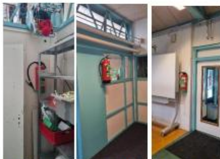
Handbrandblusser wordt geblokkeerd door de stelling en de meeste hangen veel te hoog!!!!
